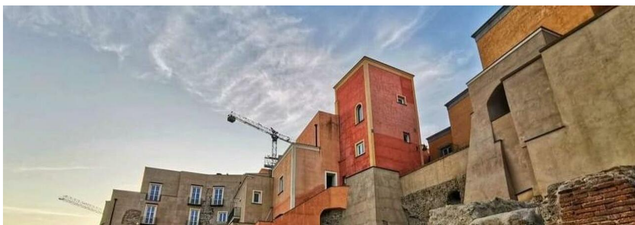
Uno scorcio del Rione Terra: nel mirino della magistratura alcuni appalti del Comune di Pozzuoli
